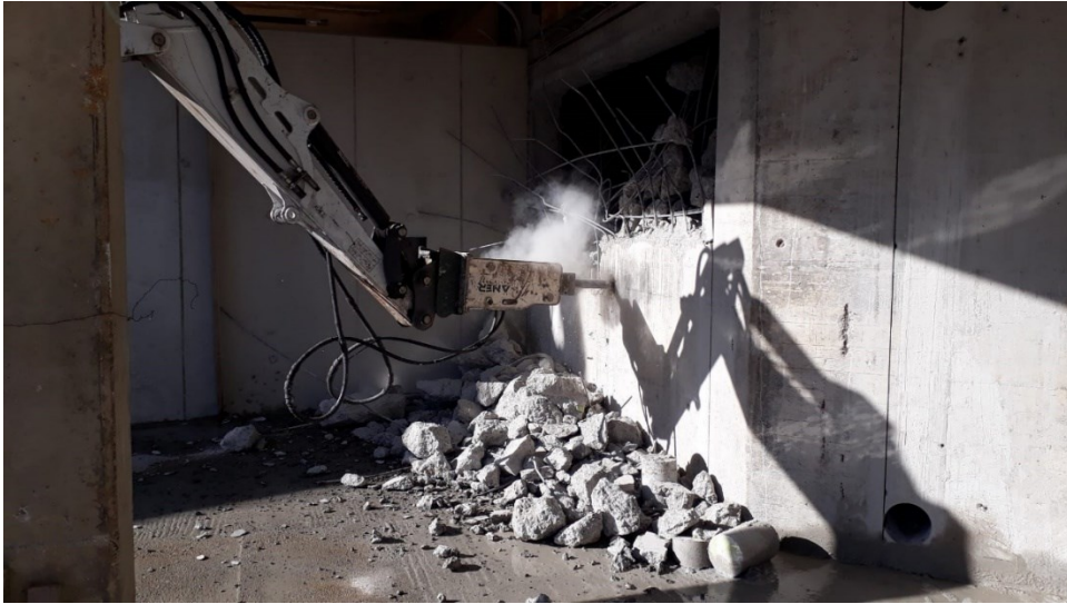
Durchbruch der Wand: Nach Prüfung des Hochwasserschutzes konnte die Gebäudehülle für die Zufahrt geöffnet werden.
